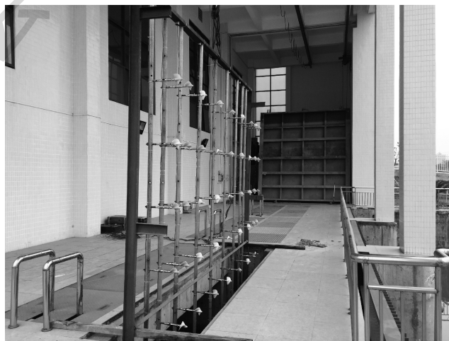
图 B.2 现场流量测试流速仪安装实景
