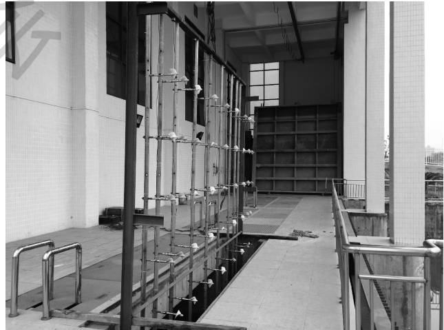
图 B.2 现场流量测试流速仪安装实景
